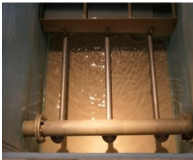
不適切な管理が行なわれている 砂ろ過設備
